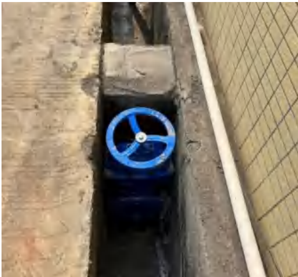
1#雨水排放口应急闸门
