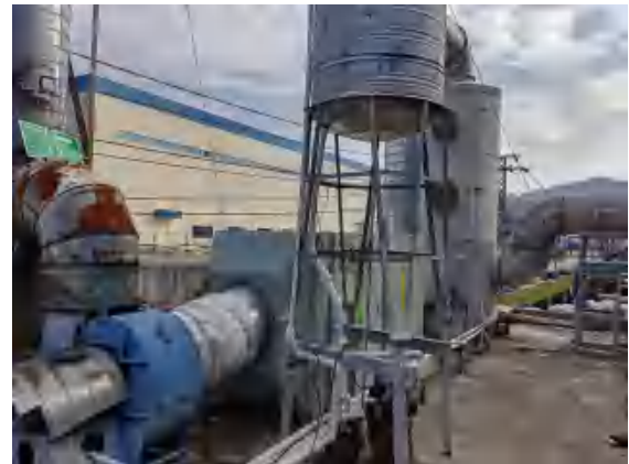
水喷淋+两级活性炭吸附 (喷漆工序)
