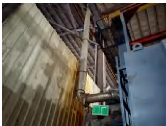
排放口标识牌, 15m 排气筒 (DA002) (2#抛丸机)
