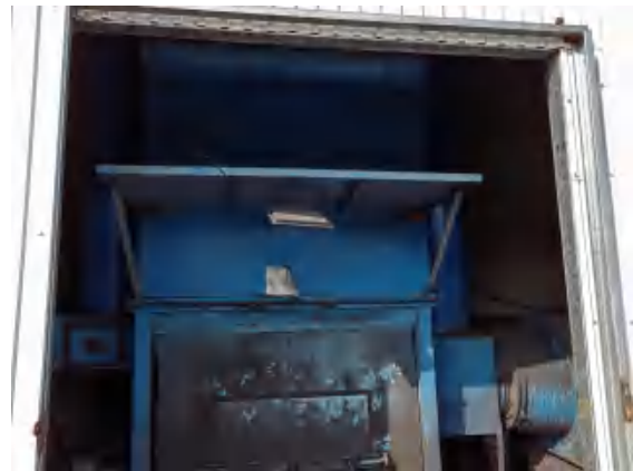
袋式除尘器（砂处理工序）
