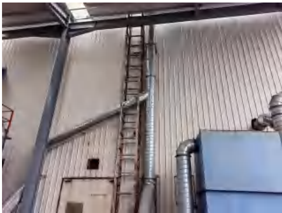
15m 排气筒（DA006）（混砂工序）
