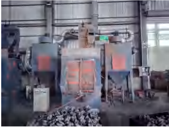
滤筒除尘器（3#抛丸机）
