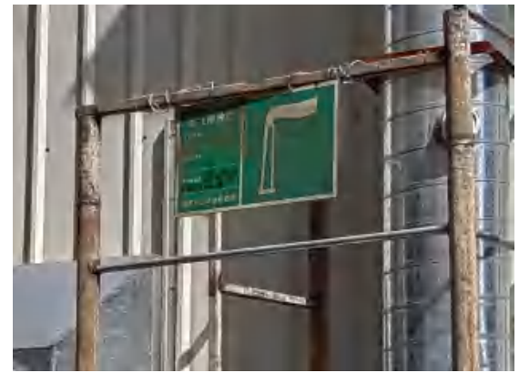
排放口标识牌 (泡漆工序)
