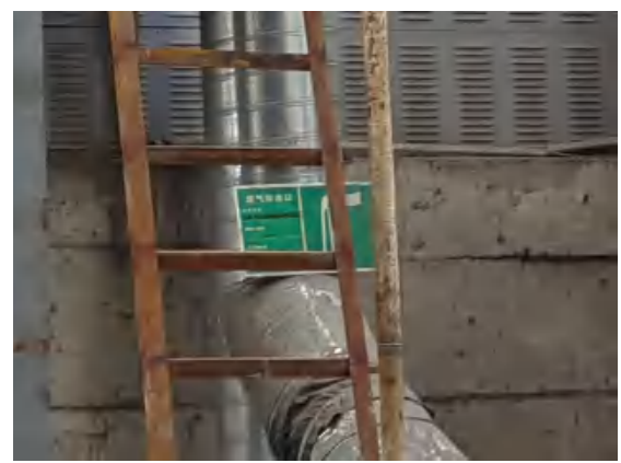
排放口标识牌（锻造、打磨焊接、补灰工序）
