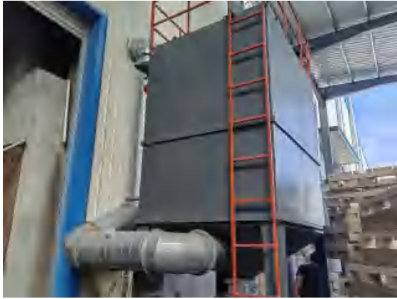
袋式除尘器（混砂工序）
