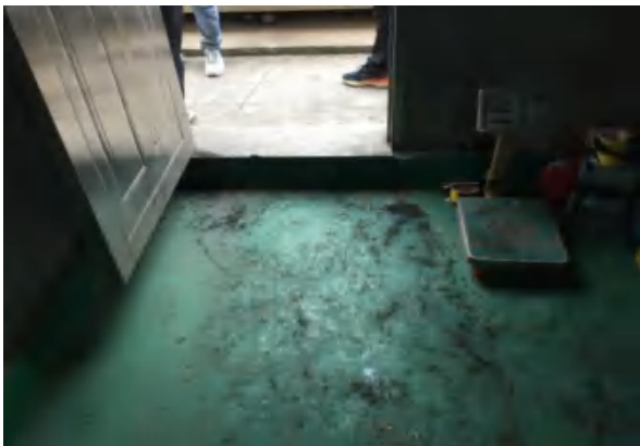
危废暂存间门口围堰、地面防腐防渗
