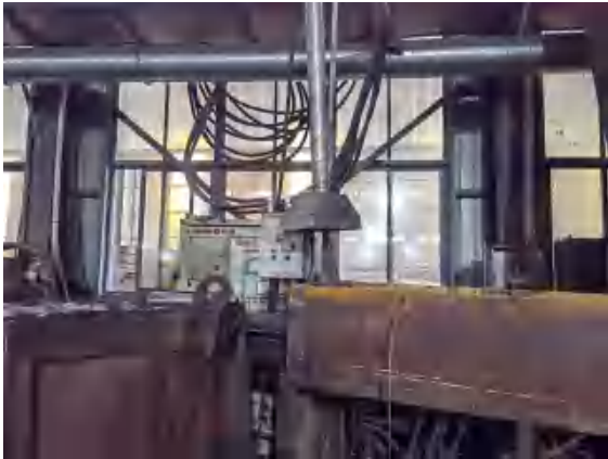
锻造车间电炉加热工序集气罩
