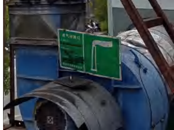
排放口标识牌（喷漆工序）
