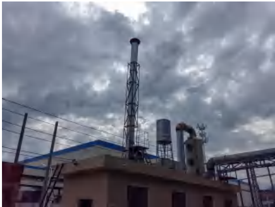
15m 排气筒（DA009）（喷漆工序）
