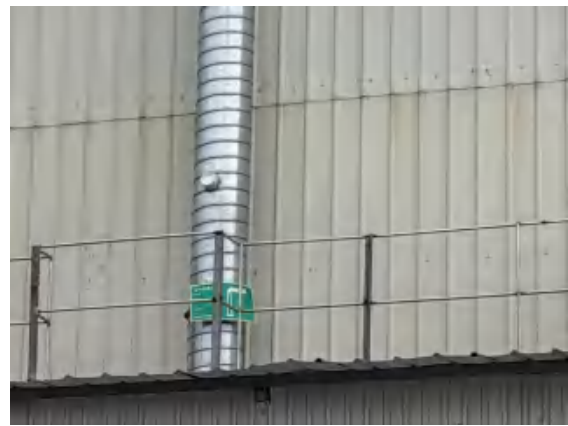
排放口标识牌, 采样平台
