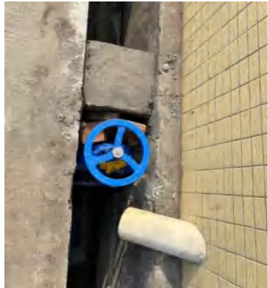
2#雨水排放口应急闸门
