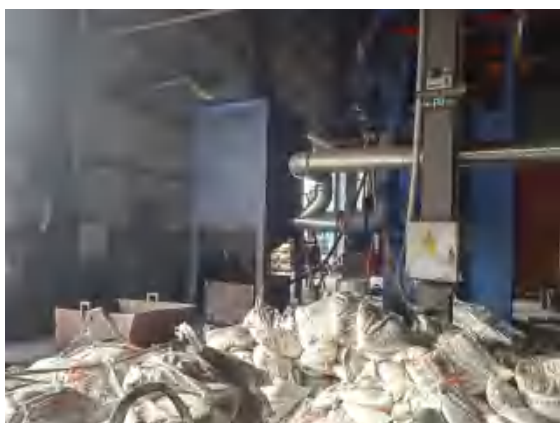
滤筒除尘器 (1#抛丸机)
