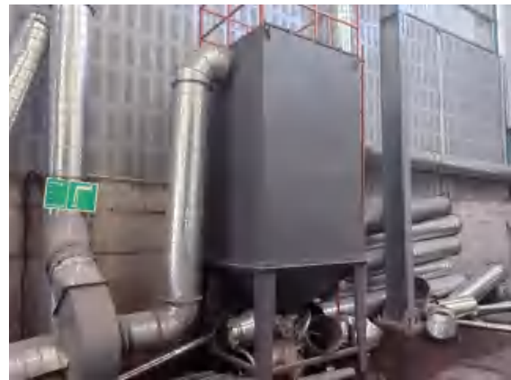
袋式除尘器（锻造、打磨焊接、补灰工序）
