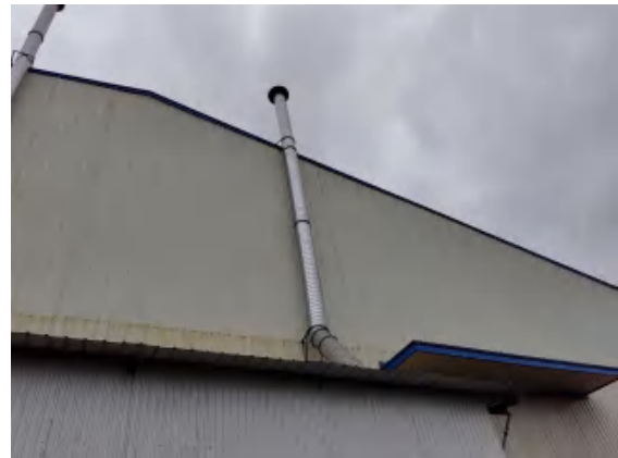
15m 排气筒（DA004）（砂处理工序）
