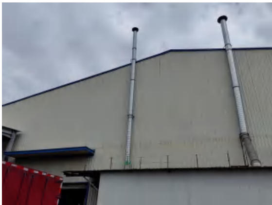
15m 排气筒 (DA005)
